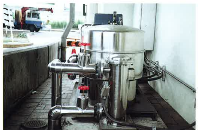
ORIGO設置例 (首都高市川S.A)
